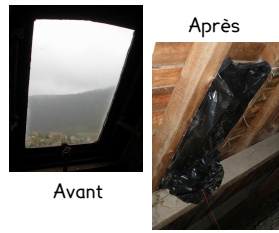
Obstruction des lucarnes
